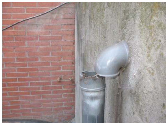
Tubería: recogida de aguas que vierten en patio cocinas
