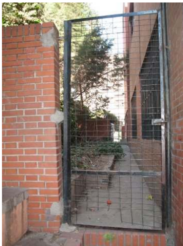
Puerta patio: con hierros en inferior izda sueltos y desvencijada
