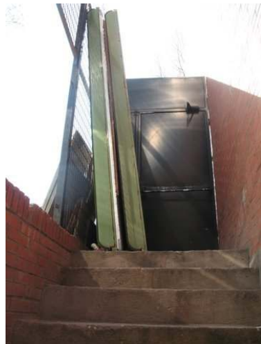
Puerta escalera: acceso siempre abierto a calderas y cocinas
